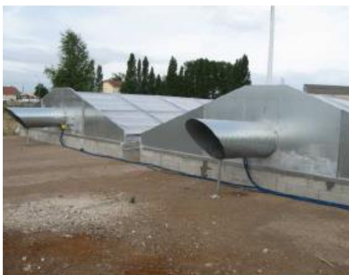
Photo 1 : conduits horizontaux d'extraction d'air des serres
